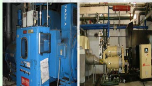
離心式空壓機汰舊換新
