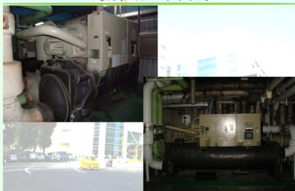
改由西側高效率冰水機(0.81kW/RT) 支援東側低效率冰水機
