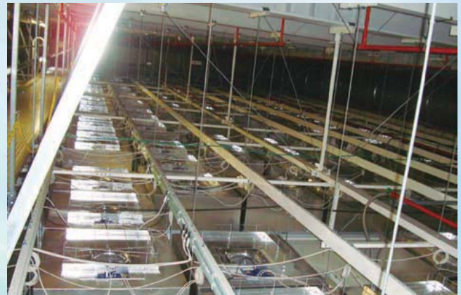
拆除FFU pre-filter可減少壓損，增加風量，相對可降低FFU轉速，節省耗電量。
