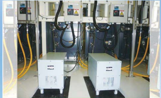
將ECO-Shock裝在Dry Pump的Exhaust piping上，改變piping的壓力(負壓)，排氣順暢後，就會降低pump的負荷，達到節能、省電的效果。
