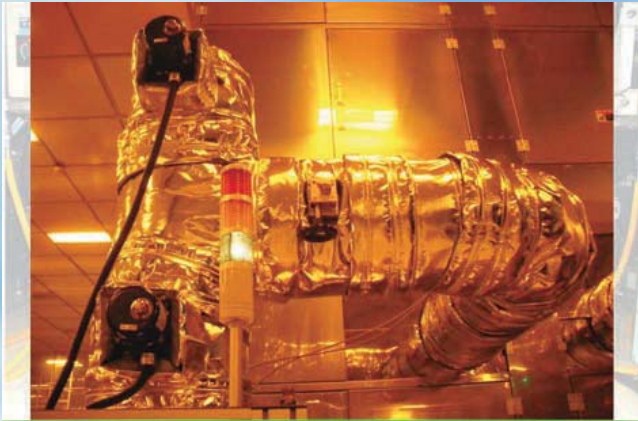
將設備使用後之廢熱於排放前利用一熱回收系統直接回收至機台再利用。
