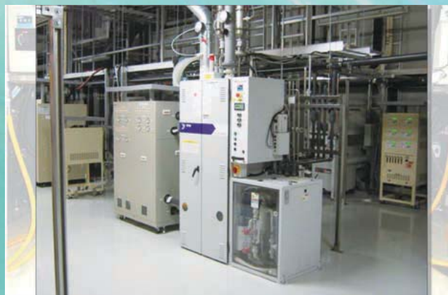
安裝SF 6 尾氣破壞去除設備，減少SF 6 殘氣直接排放造成之溫室氣體排放。
