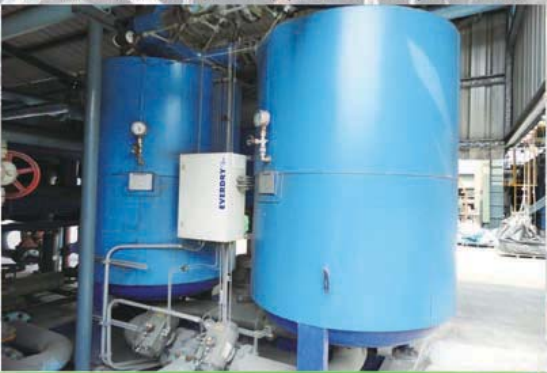
空壓機加裝加熱式分子篩(空氣除濕機)《98.04》
