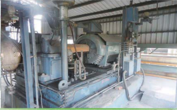
異戊醇工場使用MVR設備以電熱取代蒸氣幫助系統除水《99.5~99.10》
