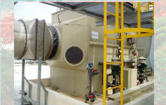
含高沸點溶劑廢氣：經冷凝器冷凝後再合併由SPX洗滌塔處理排放。
