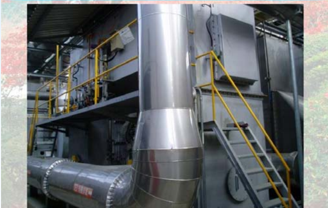
揮發性有機廢氣：經由沸石濃縮轉輪吸附、脫附、燃燒後排放，有機廢氣最高去除率可達90%以上。
