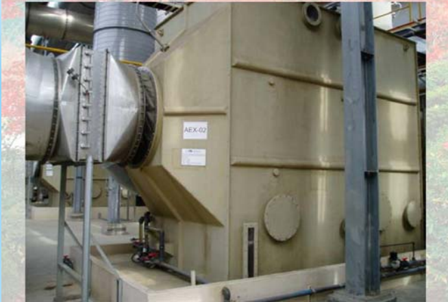
酸性廢氣：廢氣收集後經ACID洗滌塔處理排放。
