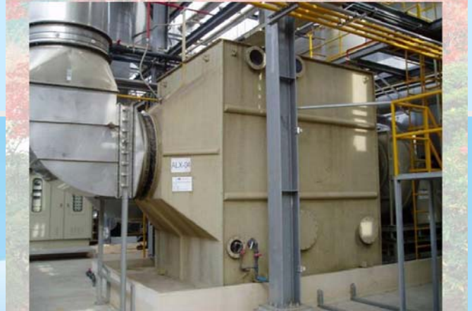
鹼性廢氣：廢氣收集後經ALK洗滌塔處理排放。
