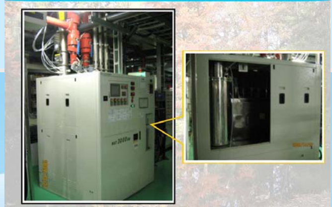
設置Thermal wet type local scrubber，處理製程尾氣，減少溫室氣體排放
