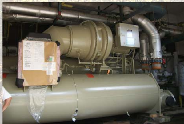
三紡、五紡、織廠冷凍主機予汰舊換新三台，節省電費
