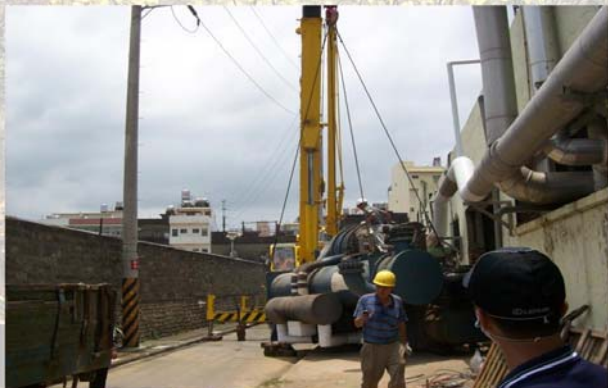
三紡、五紡、織廠冷凍主機予汰舊換新三台，節省電費
