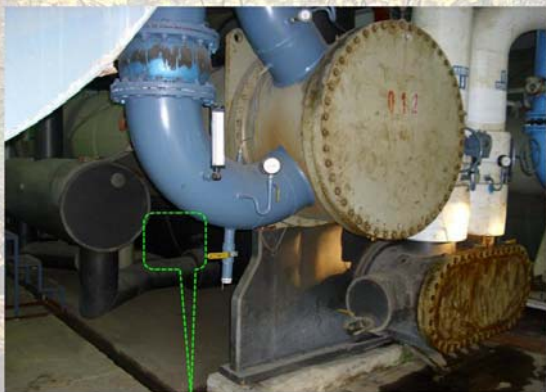
一紡#012冷凍主機使用冷媒側添加劑FRIGAID
