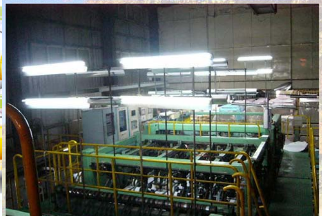
機台設備照明採用T5高效率照明以降低能源成本
