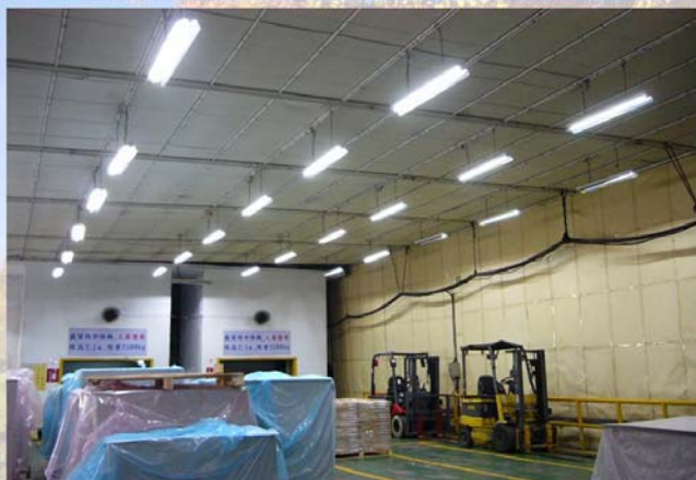
整理作業區 照明更換為高效率 T5 燈具
