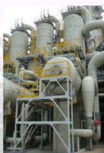
第6、7 效蒸發塔 (C-536、537)
