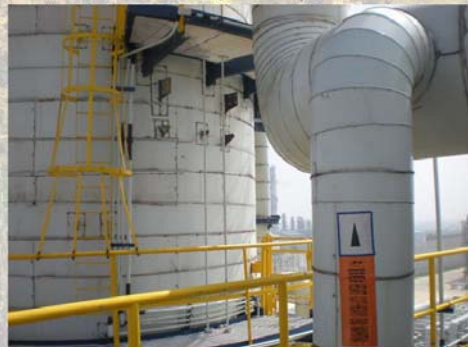
第一輕油分離塔(3C020)塔底油熱回收
