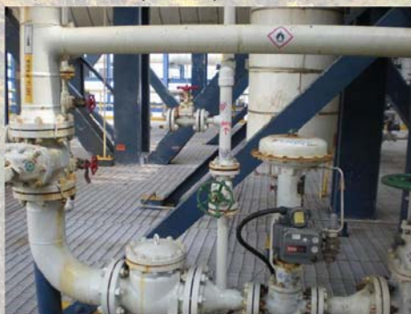
第一分離塔(3C020)塔頂排氣回收改善
