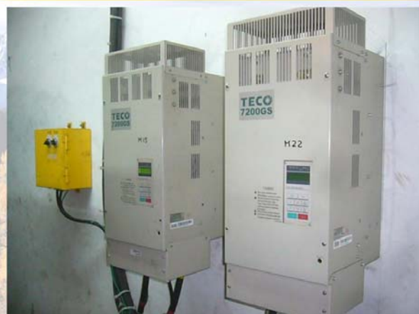
軋鋼冷卻水塔加裝變頻器，減少電力耗廢。
