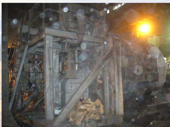
煉鋼盛鋼桶加裝蓄熱式燃燒器，減少燃料油耗用。
