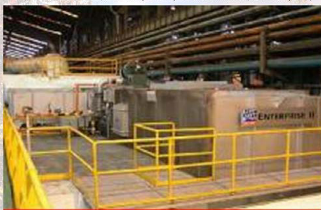
烤一線蓄熱式焚化爐(RTO)取代直燃式焚化爐(TO)
