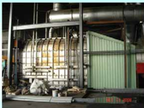
蒸汽鍋爐燃料改為木材生質能，減少二氧化碳產生量(一)。
