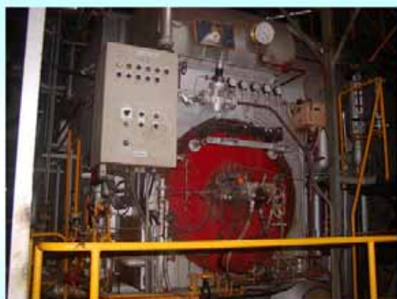
蒸汽鍋爐與工研院合作定期調整最適化，提高效率降低能源用量。
