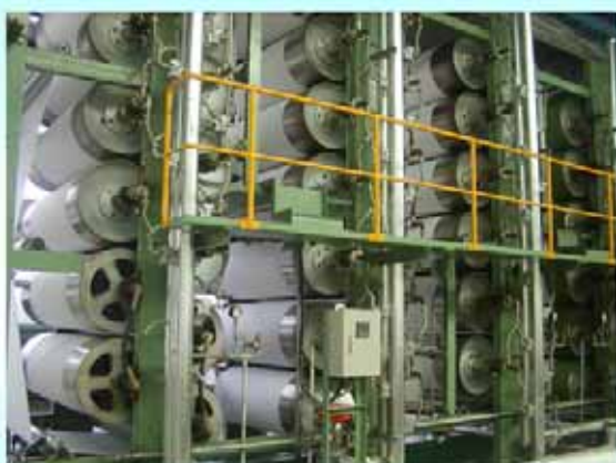
全廠卻水器與工研院合作定期檢測維修更新，減少蒸汽洩漏。
