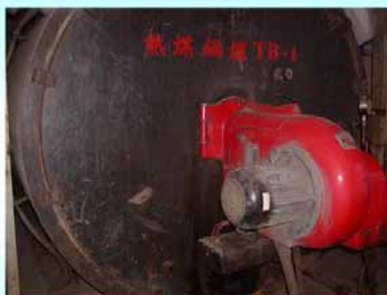
熱媒鍋爐與工研院合作定期調整最適化，提高效率降低能源用量。
