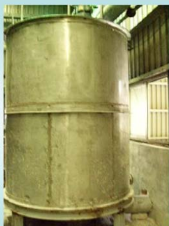
膨皂土貯存設備。
