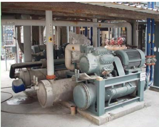
氫、氯氣洗滌塔以冷卻水取代冰水冷卻，停用一台冰水機
