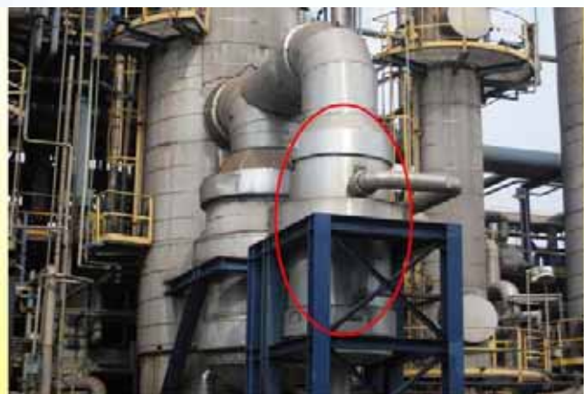
增設一座換熱器與原有換熱器並聯操作，提升製程蒸 汽使用率，減少蒸汽耗用。
