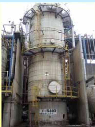
吸收塔內原陶瓷環 改用高效率之Pall Ring，節省蒸汽 用量
