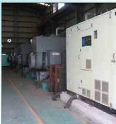
空氣壓縮機：離心式空壓機搭配具變頻螺旋式空壓機運轉，減少壓縮空氣排放，浪費電能。
