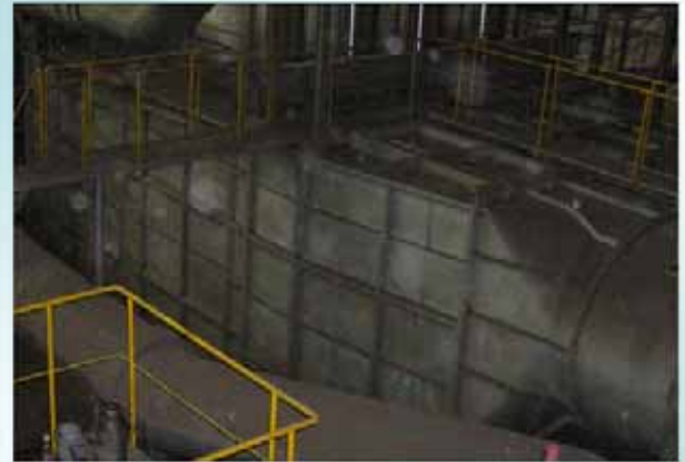
復熱器：加熱爐出口裝設高效率復熱器回收排放廢氣之廢熱。
