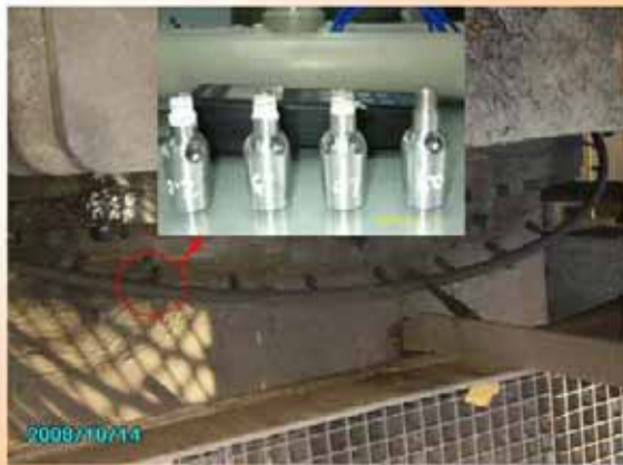
在熱風爐改以誘風式噴嘴設備來冷卻熱風爐熱點，可較傳統式噴嘴節省可觀壓縮空氣用量。
