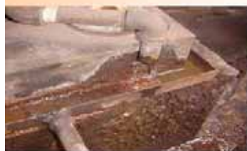
改善前： 設備老舊效率差，水封水 排放量大
