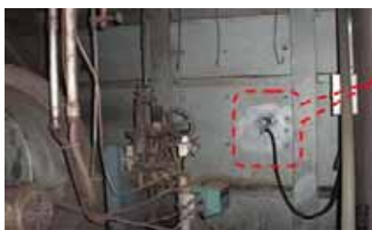
氧氣分析儀偵測加熱爐 內廢煙氣（Flue Gas） 含氧量，由加熱爐上方 移至後熱器前之廢煙氣 煙道，避免爐內火燄干擾 影響測值，提供具代 表性之測值。
