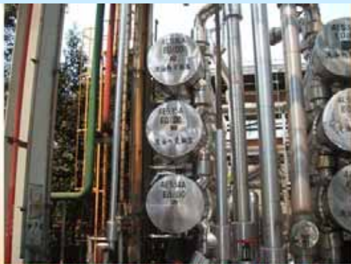
在輕油工場增設3組含苯洗油/去苯洗油熱交換器，用以回收去苯洗油熱能，可減少洗油加熱爐焦爐氣耗用量，另外苯氣原使用冷卻水來冷卻，現改由含苯洗油來吸收其熱能，亦可減少洗油加熱爐焦爐氣耗用量。
