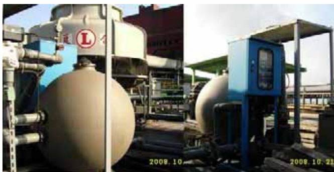
空調水塔水質處理系統： 本系統係由冷卻水塔底部抽取混濁之水源進入過濾系統中進行處理成乾淨的水後，再將水送回冷卻水塔中，並配合系統整合設備自動過濾功能、導電度值自動排放功能。達到冷卻水自動清淨效果及防止空調冰水機結垢生成，達到省電節能的目的。
