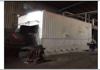
鍋爐外壁改善後 40~80°C
