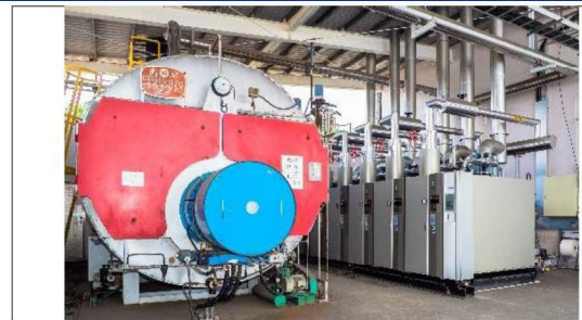
改善前(左側煙管式鍋爐)及改善後(右側貫流式鍋爐及其控制器)
