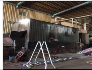
鍋爐外壁改善前 80~150°C
