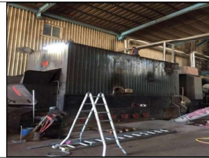
鍋爐外壁改善前 80~150°C
