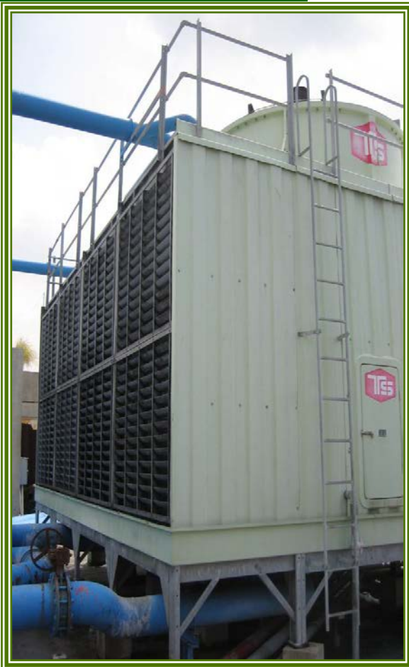
冷卻水塔外觀
