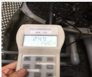
冷卻水塔未進行水質管理
