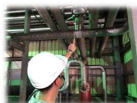
空壓系統管路洩漏檢查
