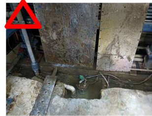
廢水收集陰井土水污染潛勢高 應定期檢視
