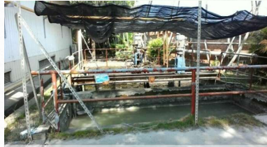
廢水槽無內覆防滲層、有破損
