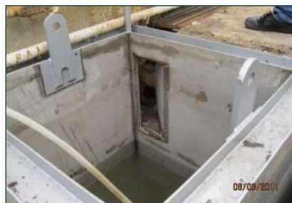
RC結構加雙層不鏽鋼 內襯之廢水暫存坑
