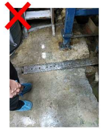
廢水處理廠地板有破損 應立即修復
