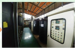
廢水處理設備地上化
