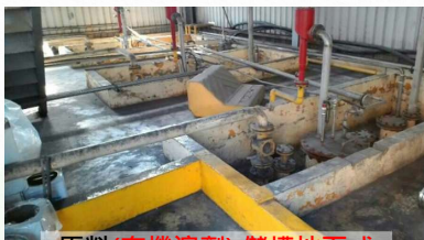
原料(有機溶劑) 儲槽地下式
