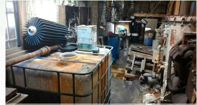
廢水處理區廢水溢流、鋪面不完整
