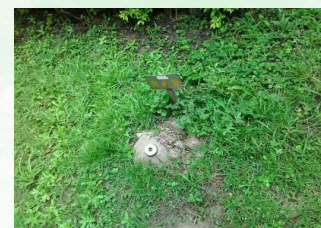
地下油槽設洩漏管
