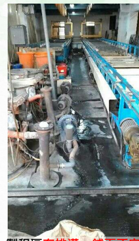
製程區有排溝、鋪面不完整
