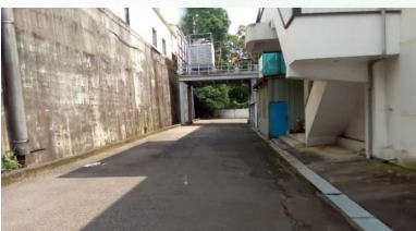
廢液以地下管線輸送
