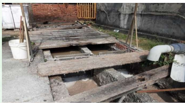
廢水以地下式排溝輸送、無防滲層
