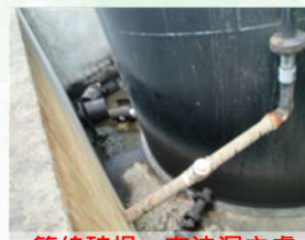
管線破損、有洩漏之虞
