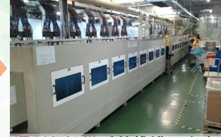
濕製程設備妥善維護、廢水明管輸送、鋪面EPOXY防護
