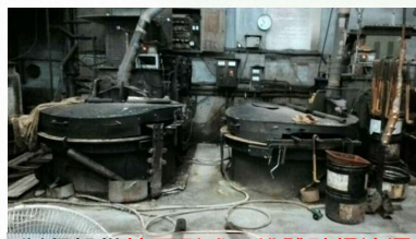
製程設備地下形式、槽體破損洩漏
