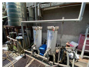
廢水廠多管濾袋過濾機提高清洗頻率
