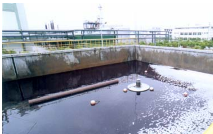
圖 9.2 批式活性污泥法 SBR 曝氣池
