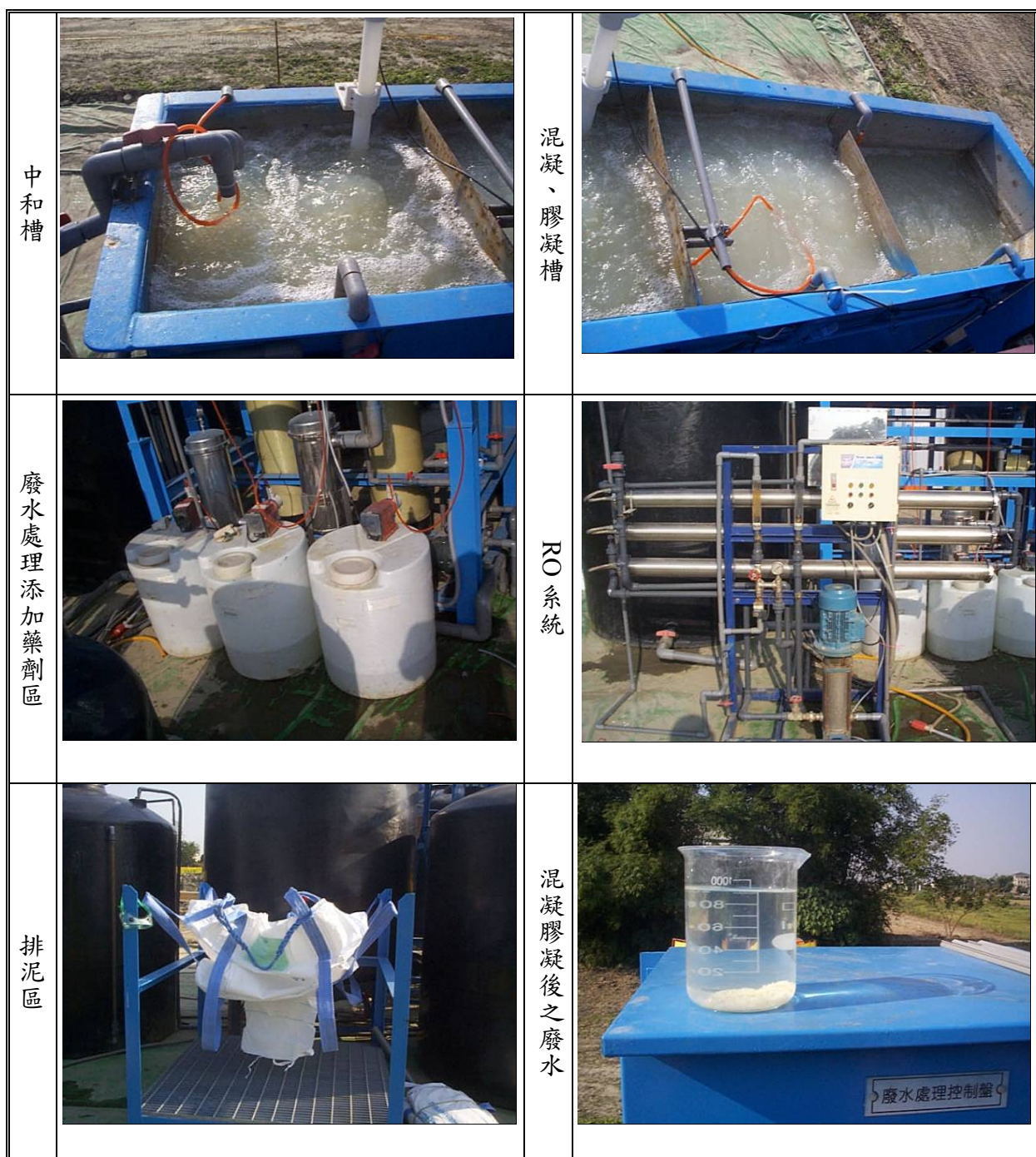
圖 5-28 廢水處理系統設備
