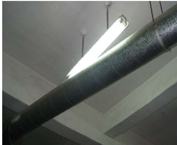
圖 4 工廠照明設備被輸送管線所遮蔽
