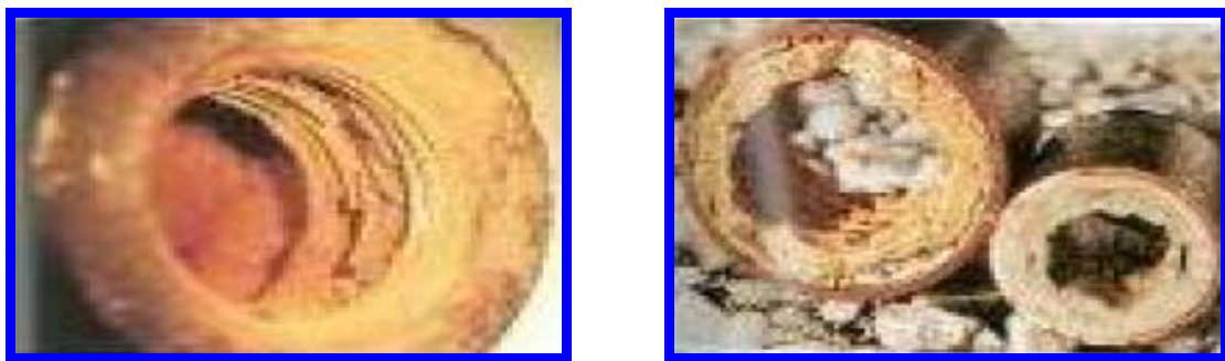
圖 3 銅製冷凝管內壁之碳酸鈣沉積及銅鐵製螺絲接縫中遭受腐蝕情形
