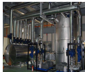
處理設備廢熱回收再利用
