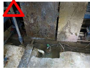
廢水收集陰井土水污染潛勢高 應定期檢視
