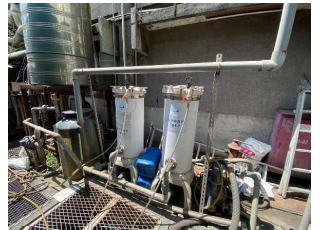
廢水廠多管濾袋過濾機 提高清洗頻率
