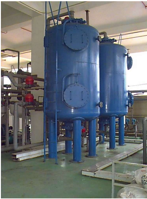
銅離子交換樹脂 處理量50 m 3 /h
