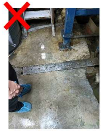
廢水處理廠地板有破損 應立即修復
