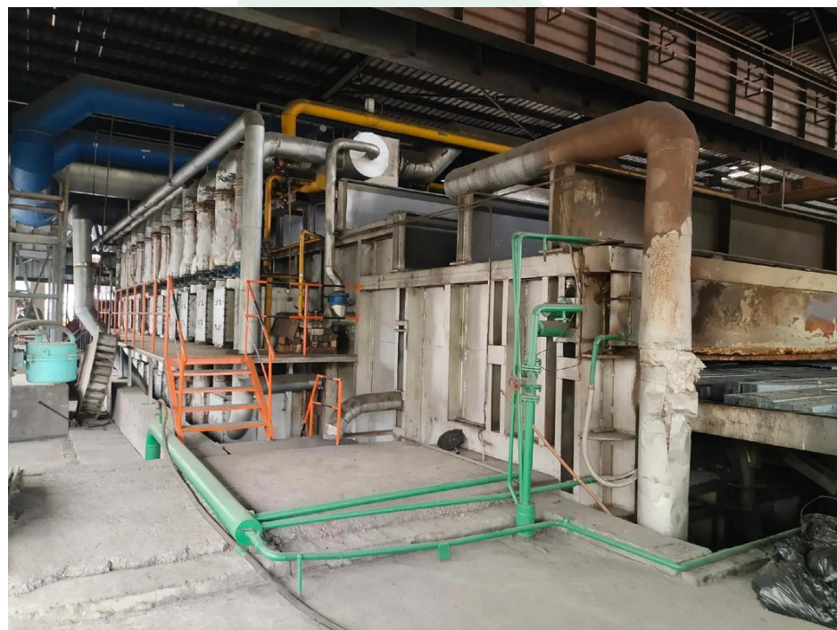
天然氣窯爐/加熱爐/熔融爐
